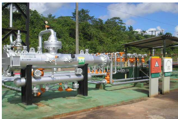
Figura 1 - Fotos do Manifold de Injeção de CO 2 no Reservatório do campo de petróleo A
